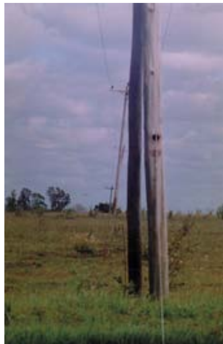
Foto 151 - Desalinhamento de postes em área de solos com argila expansiva. Uruguaiana – RS. Sérgio Hideiti Shimizu
