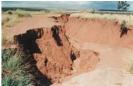
Foto 132 - Erosão em voçoroca. São Gabriel d'Oeste - MS.
