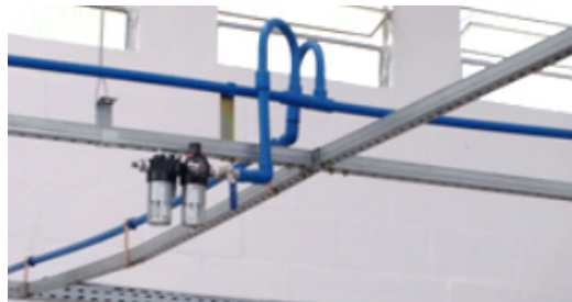
Figura 6: Linha pneumática e conjunto regulador/lubrificador.
