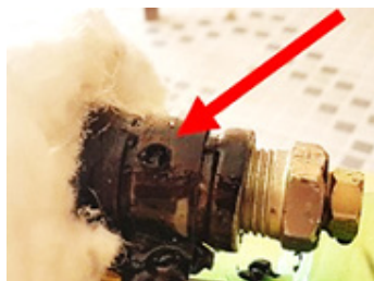
Figura 15 - Local de vazamento do material.
