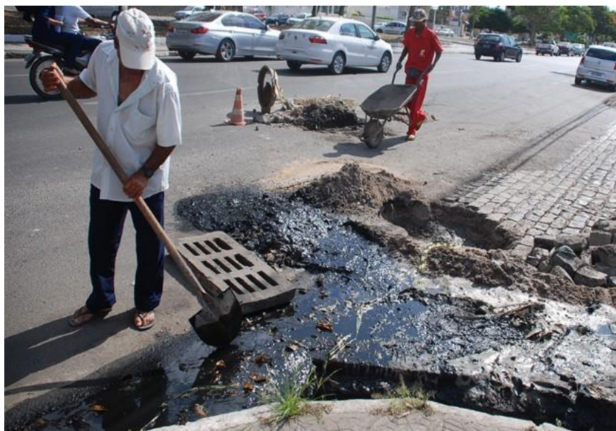
Figura 5 - Descarte irregular de lixo provoca o entupimento de bueiros e galerias no centro de Feira de Santana
