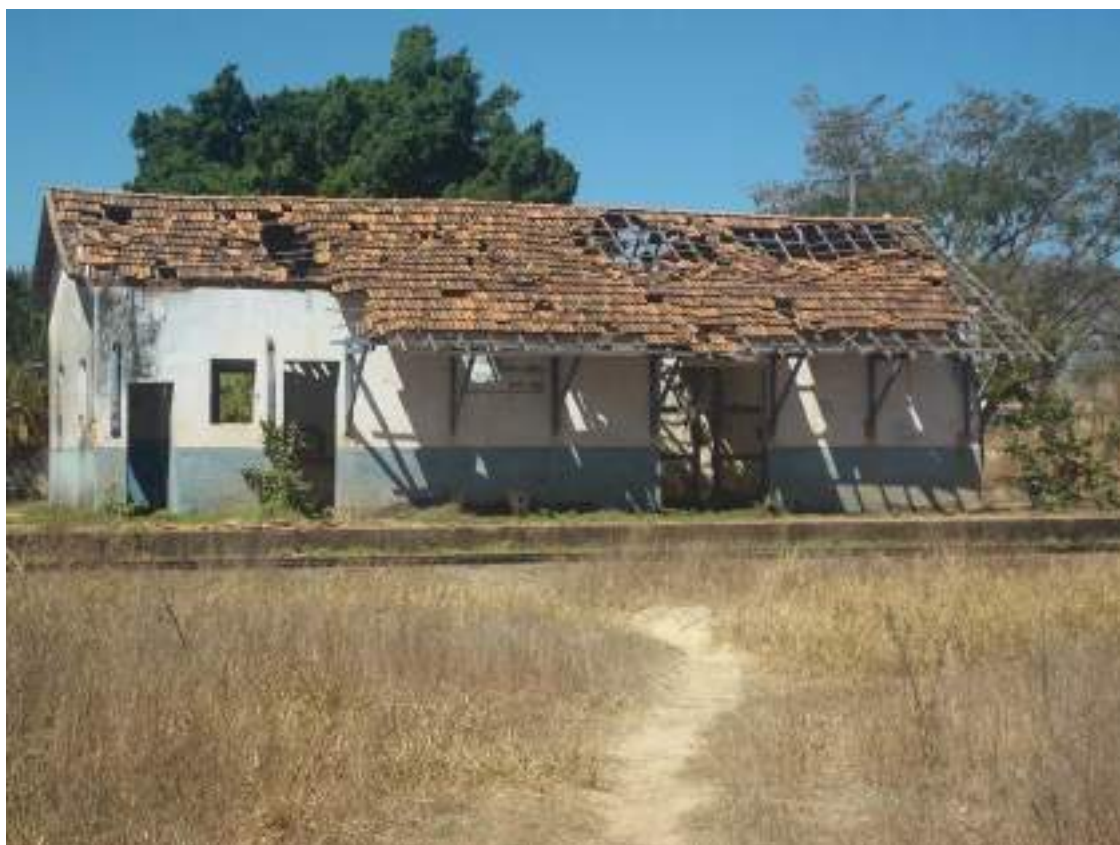
Estação de Orion – Município Capitão Enéas
