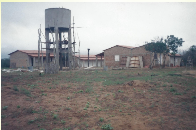
A sede da EFASE na comunidade Lagoa do Pimentel, em construção, no fim dos anos 90. Foto: Samuel de Andrade Reis.
