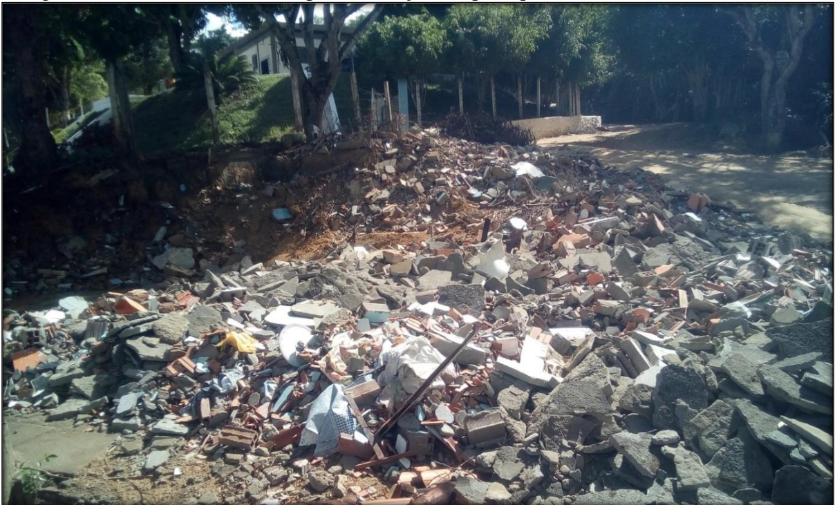
Fotografia 10: entulhos deixados após demolição de quiosques.
