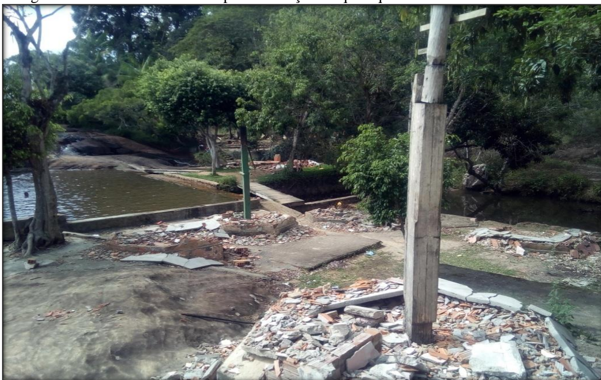
Fotografia 11: entulhos deixados após demolição de quiosques.
