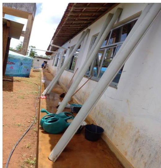
Figura 20: Manutenção das Calhas, parte do SAAC (Fonte: Acervo ETALC, 2022).
